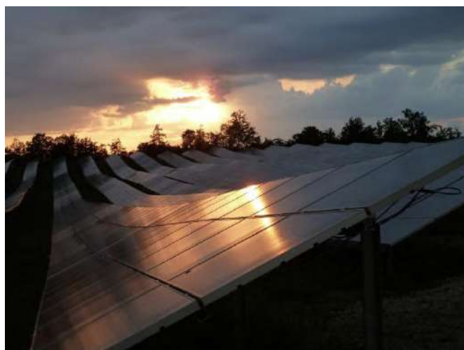
Centrale solaire du Sycala (46) - Valeco
