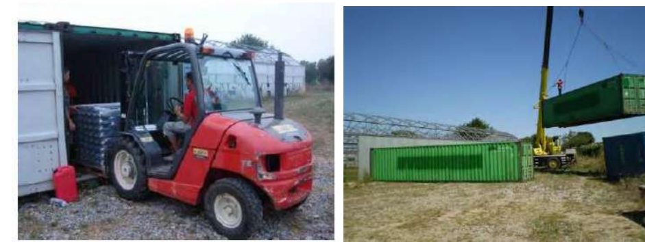
Stockage des pièces de fixation et exemple de containers de stockage
