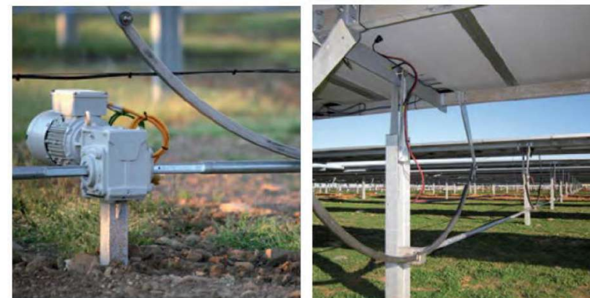
Moteurs et câblages de la centrale (illustration pour des tables dynamiques)
