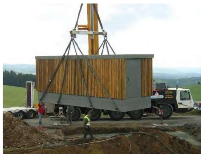
Exemple de livraison d'un poste de transformation sur un parc éolien
